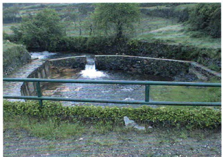
FOTO 8. Guarda metálica a substituir
